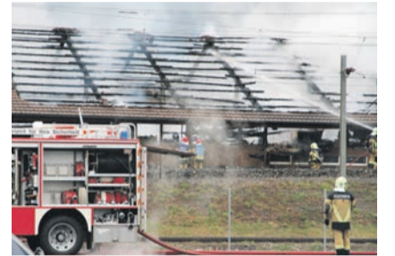
Das ausgebrannte Dach des Gebäudeteils, in welchem die Dampflokotiven untergebracht sind.
