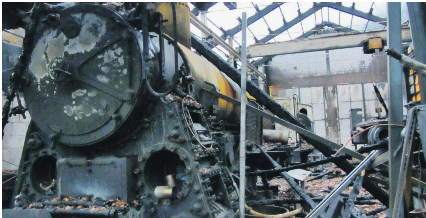
Ein Bild der Zerstörung nach dem Feuer in der Remise. Links die Lokomotive HG 3/3 1068, welche man wieder hätte instand setzen wollen. Die materiellen und finanziellen Schäden lassen sich nicht abschätzen.
